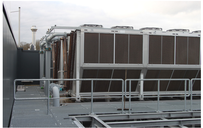
Hybridkühler der Kältemaschinen auf dem Dach führen die aufgenommene Wärme ab. (Bild: Johnson Controls)
