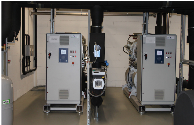
Bei Ursapharm erledigen zwei Sabroe Kältemaschinen Chill-PAC 160LV mit frequenzgesteuerter Drehzahlregelung die Prozesskühlung. Sie befinden sich in einer separat gebauten Kältezentrale des Kunden. (Bild: Johnson Controls)
