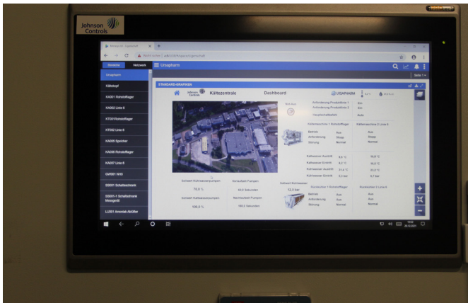
Über das Dashboard läuft die übergeordnete Steuerung für die komplette Kälteerzeugung der neu aufgebauten Produktionsstätte bei Ursapharm. (Bild: Johnson Controls)
